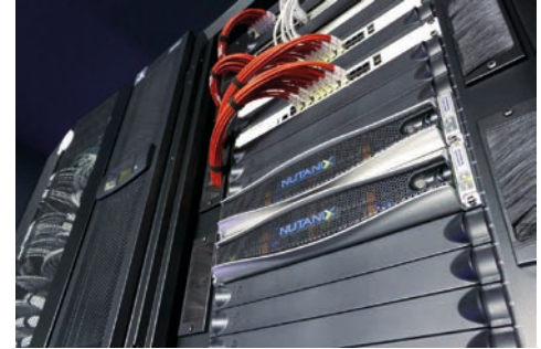
Data Center LEAS equipaggiato con macchine Nutanix
